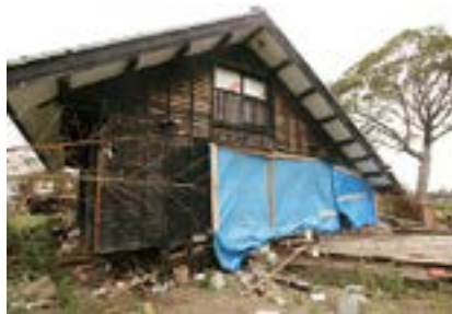
津波で流出・大破した自宅
